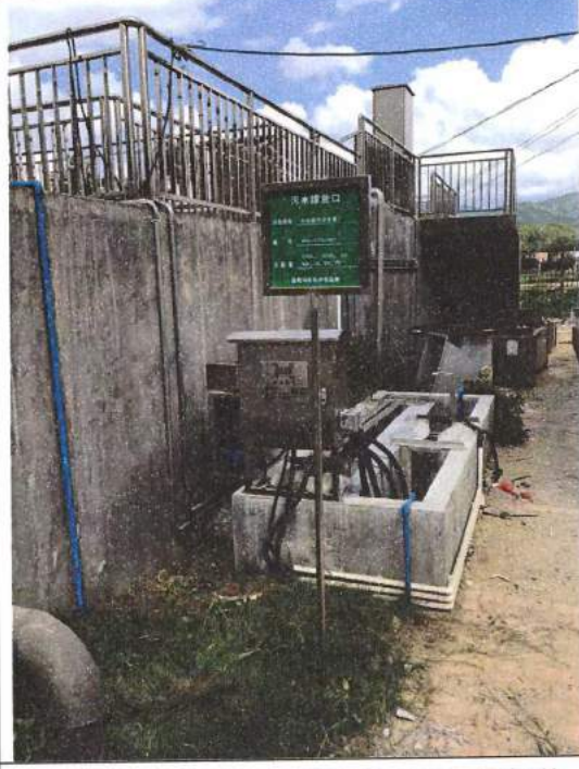
沙田镇污水处理厂废水排放口及标识标牌
