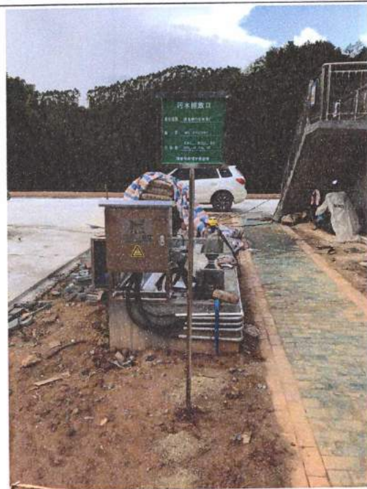
遥田镇污水处理厂废水排放口及标识标牌
