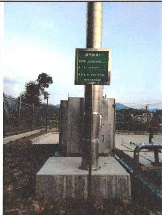
沙田镇污水处理厂废气排放口及标识标牌
