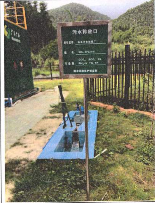
石角污水处理厂废水排放口及标识标牌
