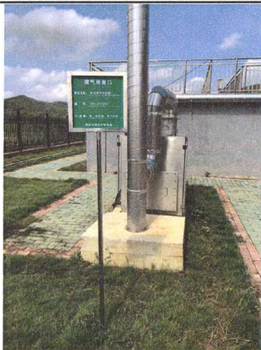
回龙镇污水处理厂废气排放口及标识标牌
