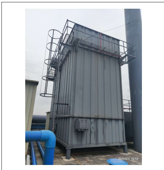
图1 高压静电回收塔
