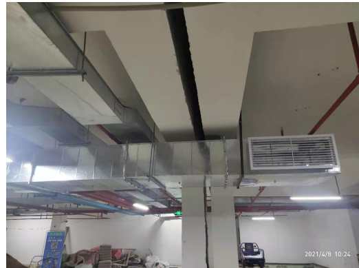
图片6 地下停车场汽车尾气吸风口
