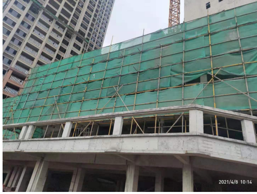
图片 1 楼房防尘网
