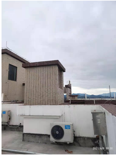
图片3 发电机烟气排放口
