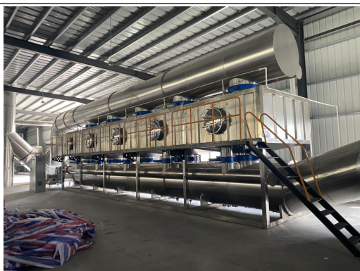
图3 吸附+脱附+催化燃烧 (RCO)
